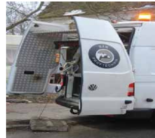
Die Regenwasserkanäle wurden gereinigt und der Zustand wurde per Kamerabefahrung erfasst. Die Behebung der Schäden erfolgt nach Dringlichkeit
